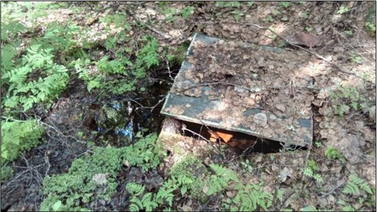
Kuva 49. Vedenottokäytössä oleva lähde L3 ja sen ympäristön tihkuisuutta.
