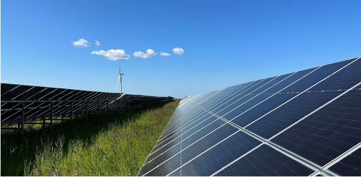
Maa-asenteinen aurinkopaneeliteline Oulun Vihreäsaassa
